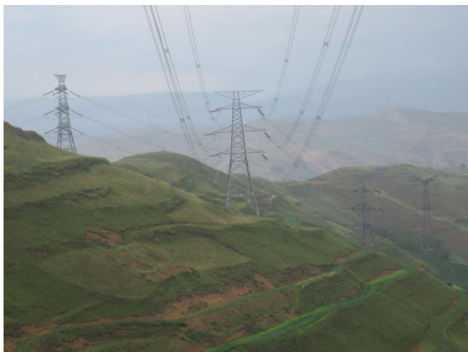
继管线 07#、恒康线 45#塔线路 \pi 接状
