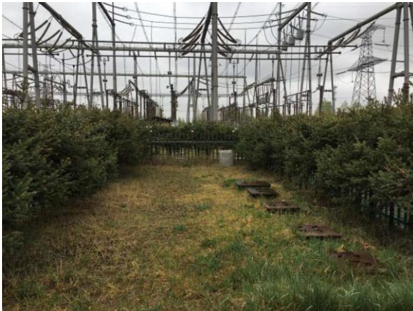
西宁 750kV 变电站 地理式生活污水处理装置
