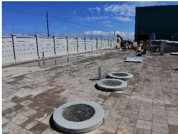
海南 750kV 变电站 地理式生活污水处理装置 图 9-1 变电站地理式生活污水处理设施
