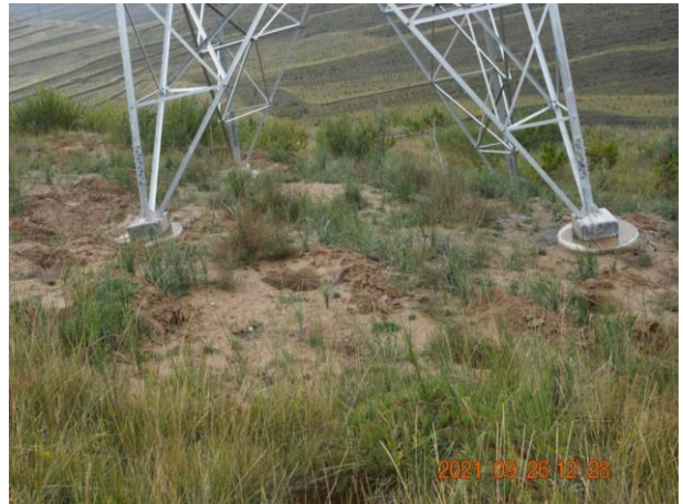
宁树 II 回 37 塔基
