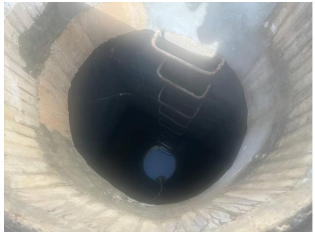
高抗事故油池内部
