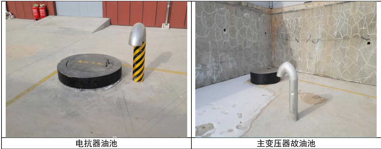
图 12-1 变电站内事故应急设施
