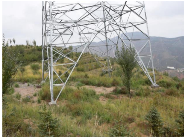
宁树 II 回 38 塔基
