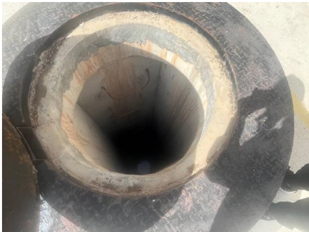
主变事故油池内部
